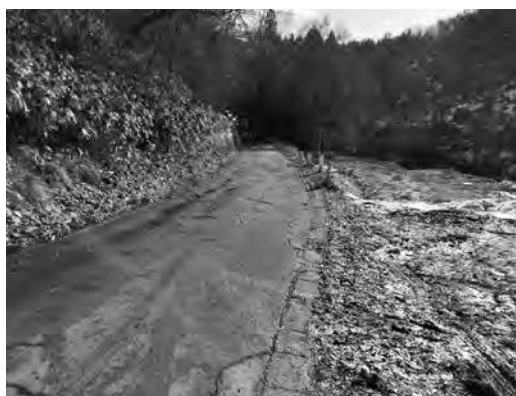
町道漆窪～泥浮の路面状態
