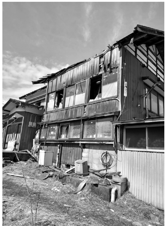
放置された空き家
